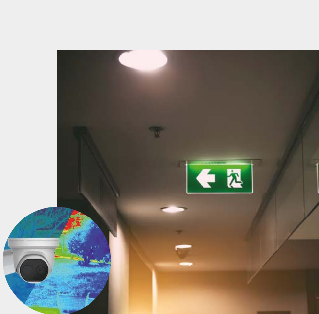
telecamere termiche e rilevatori fumo
